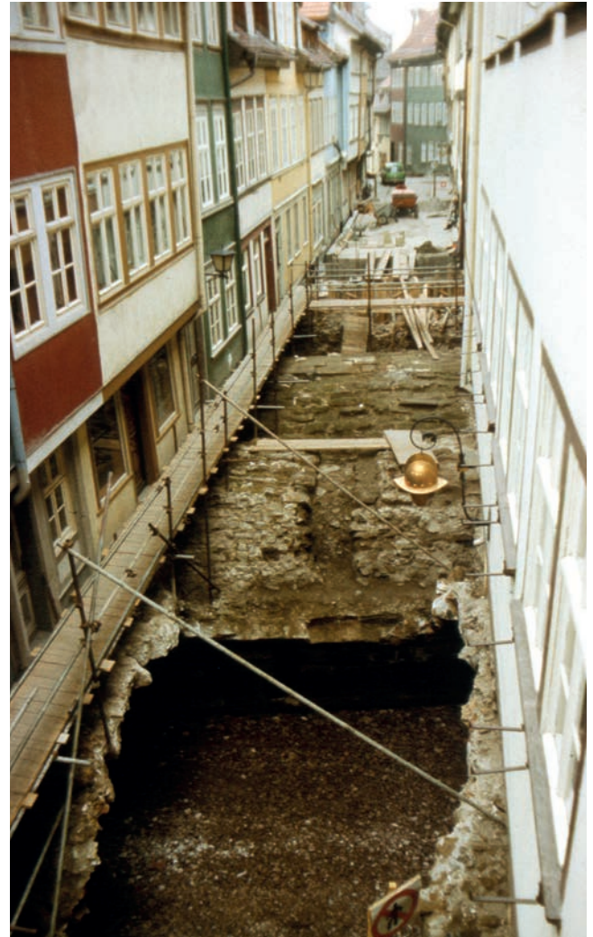
Bild 11: Erneuerung, Reprofilierung und Ertüchtigung des mittleren Teils der Naturstein-Gewölbekonstruktion zwischen den Häuserfluchten im Rahmen der Instandsetzung 1985/86
